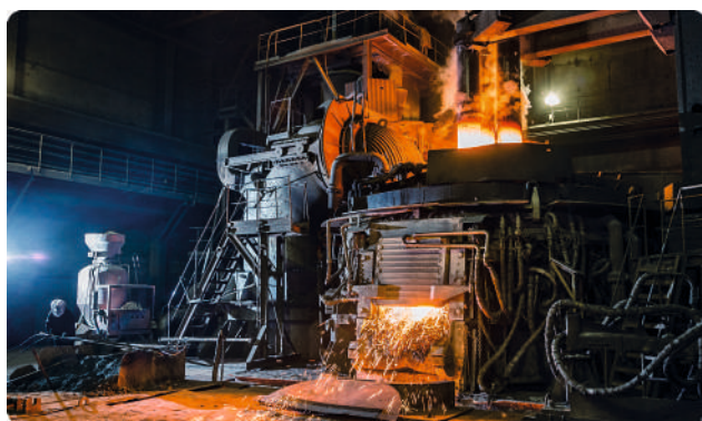
Дуговая электросталеплавильная печь ДСП 60/70 (FAI-FUCHS)
